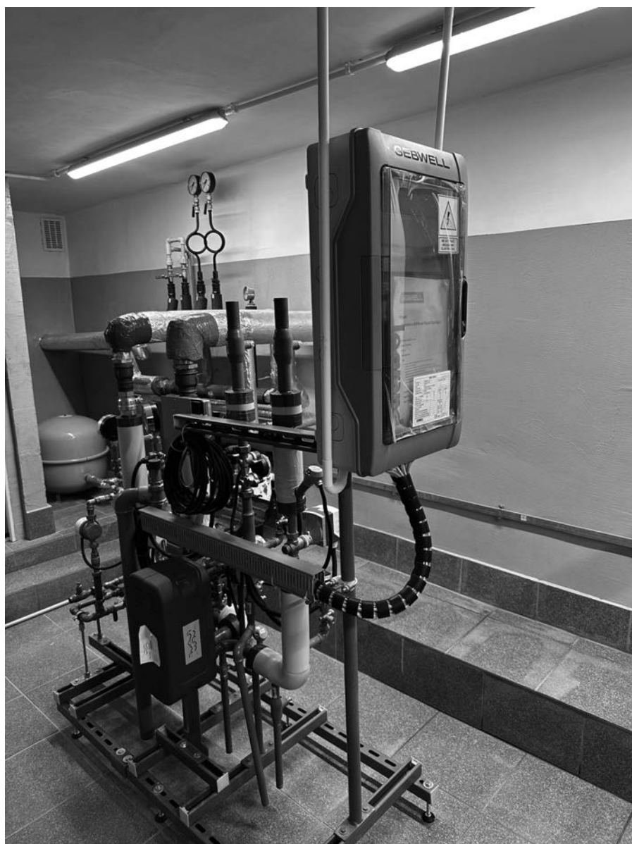
Zdjęcie: Pomieszczenie wymiennika ciepła przy ul. Kaliny 62
